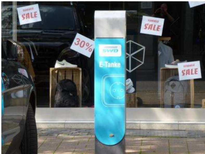
Abb. 48 Ladesäule in der Dürener Wilhelmstraße
