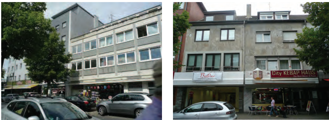
Abb. 34 Modernisierungsbedürftige Fassaden in der Josef-Schregel-Straße
