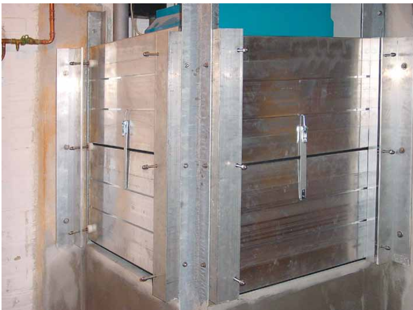
Sicherung eines Heizbrenners
