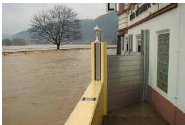
Umlaufender Hochwasserschutz mit teilmobile Schutzelementen
